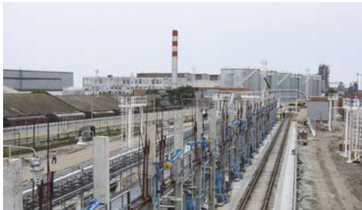
На фотографии: общий вид на эстакаду слива мазута на территории ОАО «Таганрогский судоремонтный завод»
